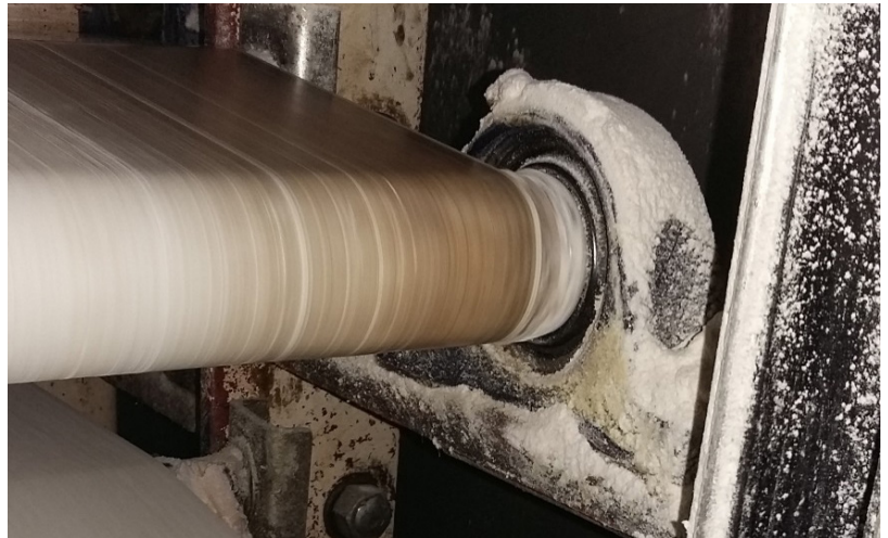
Le particelle di farina possono essere estremamente dannose per cuscinetti inadeguati montati su nastri trasportatori in impianti di produzione di pasta
