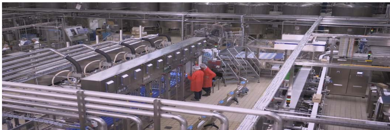
Il sito di Ferentino è tra i primi 4 stabilimenti del gruppo per entità di investimenti. Nel 2019 sono stati installati un nuovo impianto di trigenerazione, 2 nuove linee di produzione, 1 isola di palletizzazione
