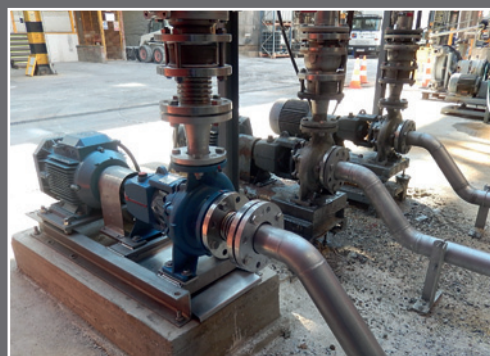
Nuova piastra base del motore con bulloni di regolazione presso il sito produttivo di Montmeló
