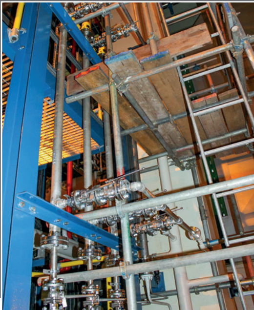
Tubature di collegamento del serbatoio della condensa con tre sensori radar ad onda guidata di tipo VEGAFLEX 81 nei tubi di bypass
